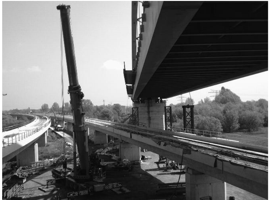
Kreuzungsbereiche unterhalb der Stabbogenbrücke. (Foto: Dr.-Ing. Ellinger)
