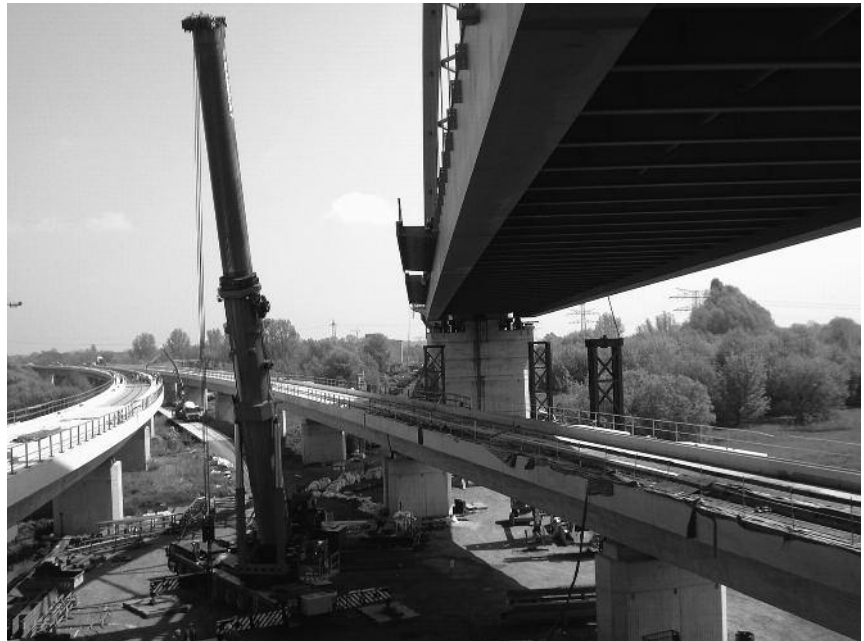
Kreuzungsbereiche unterhalb der Stabbogenbrücke. (Foto: Dr.-Ing. Ellinger)
